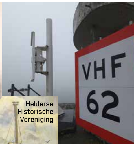
Misthoorn op Wierhoofd door Verkeerscentrale Den Helder
